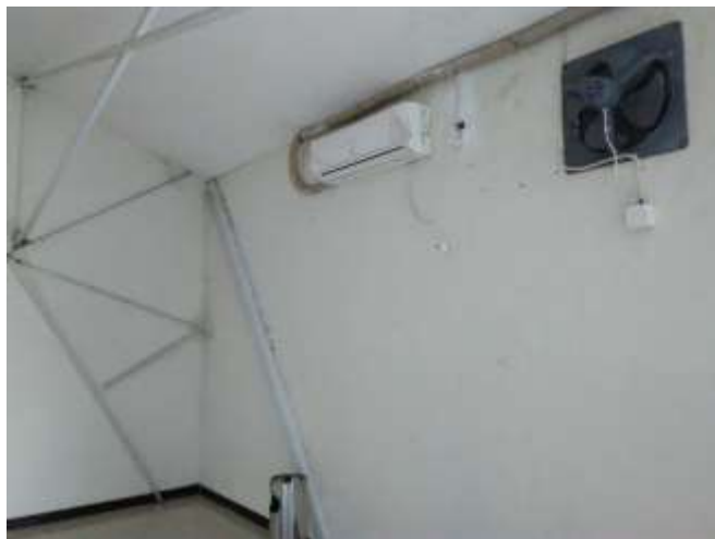
Gambar 27. Air Conditioner pada Ruang Lansia (Sumber: Dokumentasi Hasil Survey, Mei 2018)
