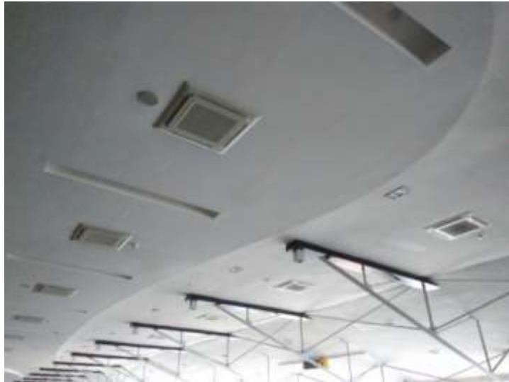
Gambar 24. Penghawaan Buatan Terminal Penumpang (Sumber: Dokumentasi Hasil Survey, Mei 2018)
