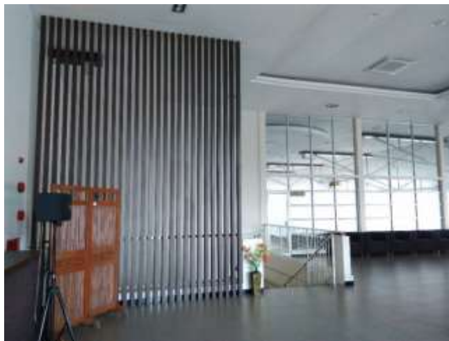
Gambar 25. Display Speaker pada Area Terminal Penumpang (Sumber: Dokumentasi Hasil Survey, Mei 2018)
